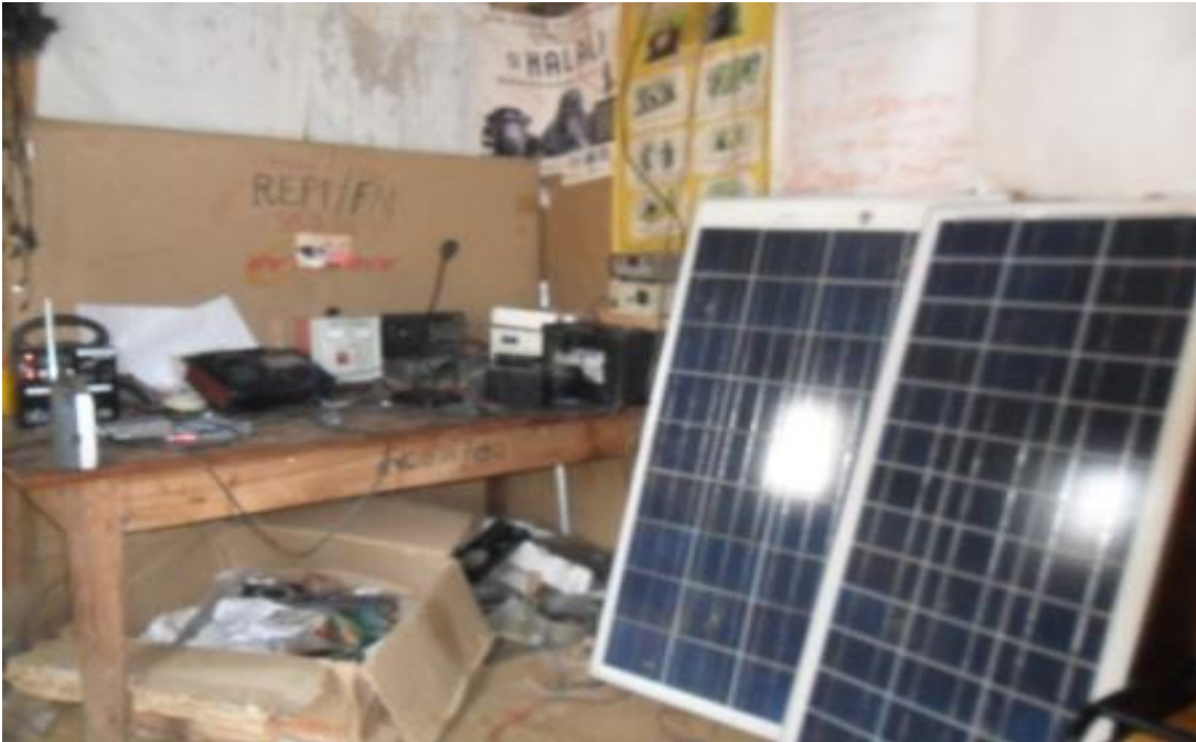
Les deux panneaux comme sources d'énergie de la radio endommagés, photo RCGW, 5 septembre 2015
