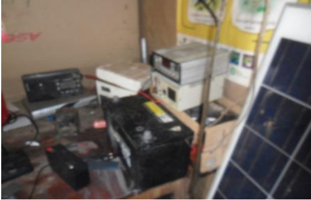
Equipement du studio de la REPI-FM touché par la foudre
